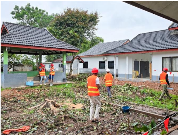
Im Spital Luang Namtha haben die Bauarbeiten für die neue Kinder- und Neugeborenen-Intensivstation begonnen.
